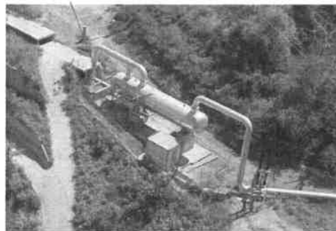
Conduite diphasique du fluide géothermal
